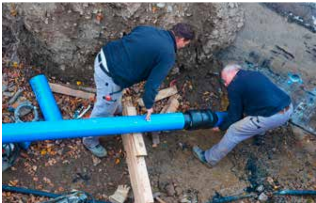
Für die Verlegung der SIMONA® Druckrohrleitungen sind verschiedene lokale Baufirmen im Einsatz. Dank des geringen Eigengewichtes, selbst bei großen Rohrlängen, sind die Leitungen schnell und effizient verbaut. Foto: SIMONA AG
