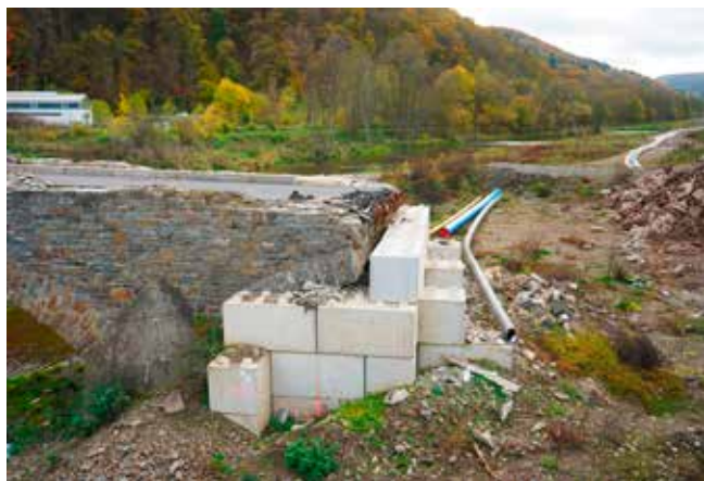
Die Flutkatastrophe im Juli 2021 hat verheerende Schäden im Ahrtal angerichtet. Brücken, Straßen und weitere Teile der Infrastruktur wurden zerstört, sodass nach dem Hochwasser bis zu 26 Ortsgemeinden der beiden Verbandsgemeinden von der Trinkwasserversorgung abgeschnitten waren. Foto: SIMONA AG
