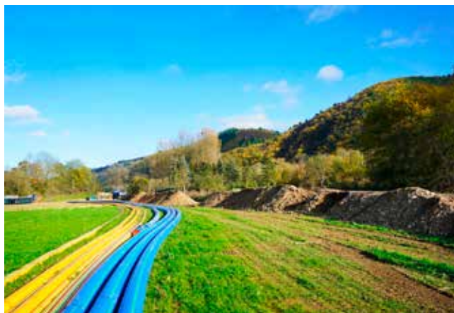
Für den Neuaufbau der Infrastrukturen im Ahrtal werden insgesamt 36,5 Kilometer PE 100-RC Line und PE 100-RC Line SPC Druckrohre von SIMONA® verlegt. Foto: SIMONA AG
